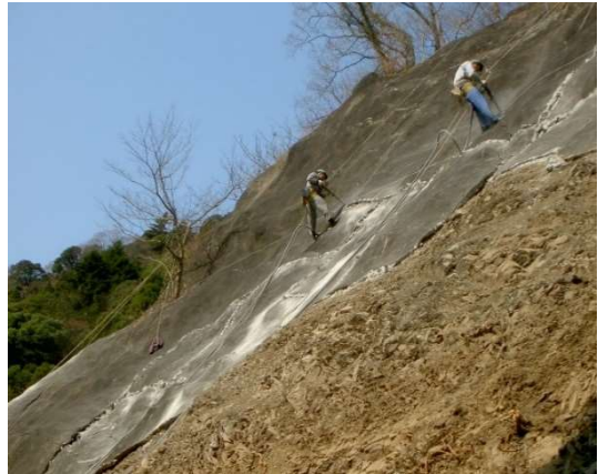
取壊後の風化した地山状況
