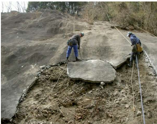
モルタル片の剥ぎ落とし
